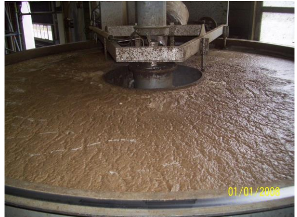
Flotationsbecken mit Räumern
